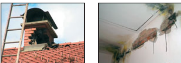
Abbildung 5: Einschlagpunkt im Rauchfang (links), Übergang des Stromes in die Elektroinstallation
