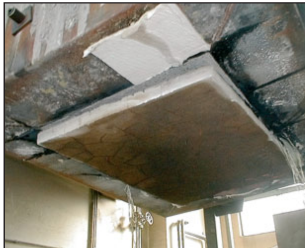
Abbildung 10: Schutzschicht nach dem Brandversuch
