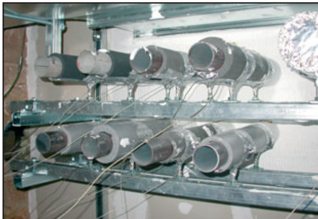
Abschottung nicht-brennbarer Rohre mit brennbaren Isolierungen mittels Brandschutzband.
