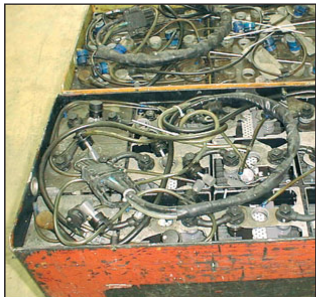
Zerstörte Staplerbatterie durch Funkenbildung einer nicht geeigneten Arbeitskleidung.
